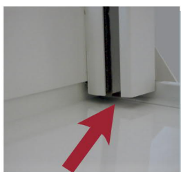
Bild 1 Für viele Schäden verantwortlich: Fehlende Abdichtung (Gewerkeloch) hinter der Führungsschiene.
