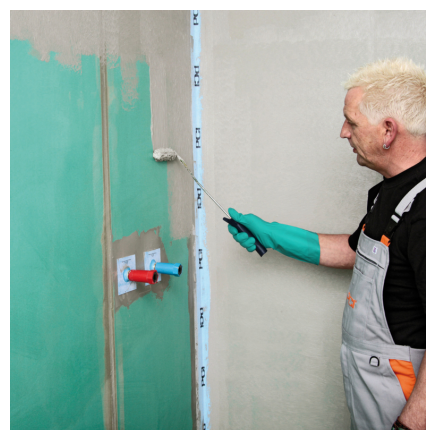
Nachdem die Details ausgebildet wurden, erfolgt die Flächenabdichtung mit dem jeweiligen Abdichtungsmaterial.
