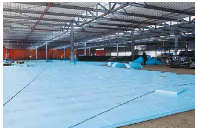
Abb. 39: XPS Bodendämmung in einer Werkshalle
