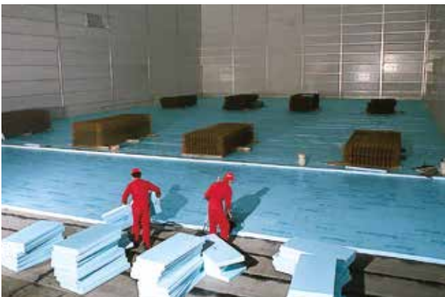
Abb. 38: XPS Bodendämmung in einem Tiefkühlhaus
