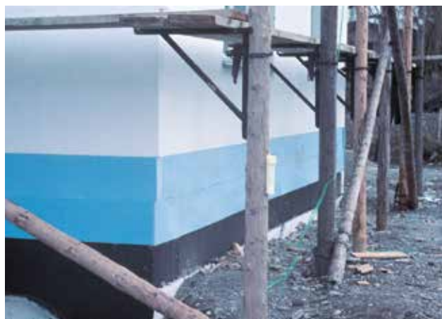
Abb. 43: XPS-Sockeldämmung im Spritzwasserbereich
