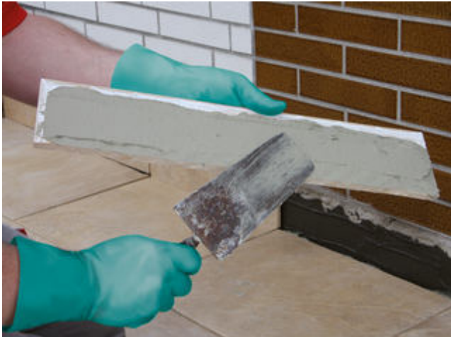
19) Auftragen eines Sopro Flexklebers (z. B. Sopro's No. 1, Sopro FKM® XL) auf die Rückseite der zurechtgeschnittenen Sockelfliese ...
