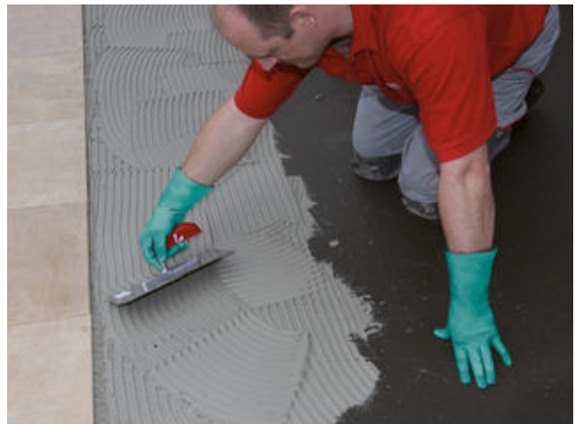
16) Auftragen des zweikomponentigen Flexklebers Sopro megaFlex S2 oder Sopro megaFlex S2 turbo auf die ausgehärtete Abdichtung.
